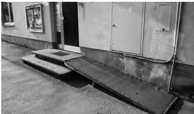
Abbildung 2 – Gefährlich filigrane und schmale Rampe (Bibliothek – Reichenauerstraße)
